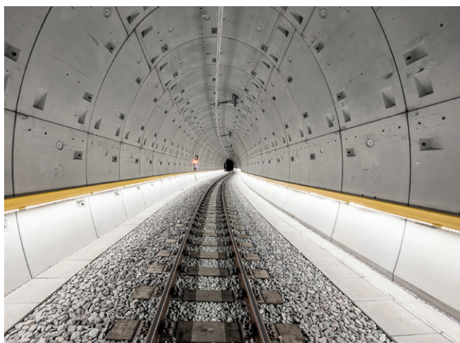
LaneLED GFK, Glatscheras tunnel
